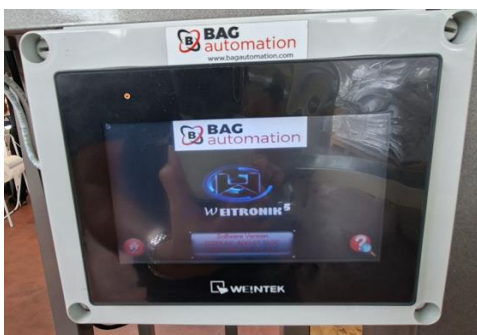
Fig.6 vista del display dello strumento AWI / AWI display view.
