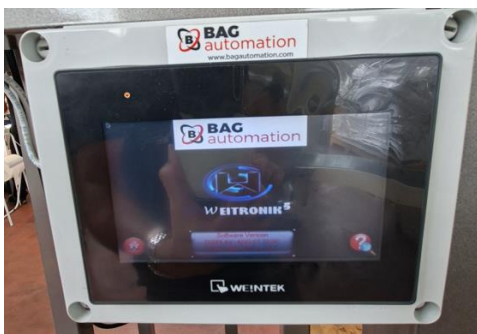
Fig.8 vista del display dello strumento AWI / AWI display view.
